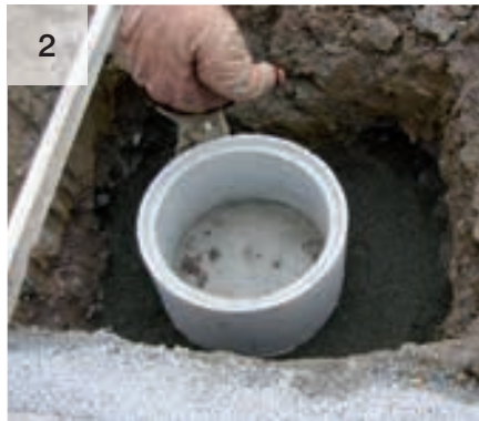
Pozzetto in calcestruzzo (a cura del cliente).
